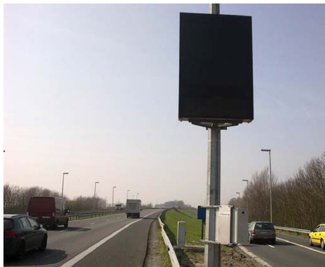
Dynamische signalisatie tussen Veurne en Adinkerke
